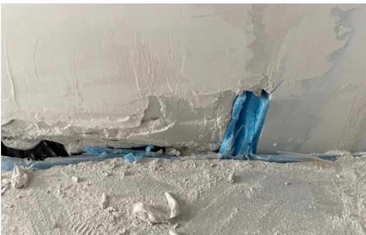
Mörtelreste in den Randfugen und fehlerhafte Randdämmstreifen können zu Schallschutzproblemen führen. © www.bsb-ev.de
